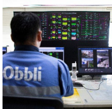
コントロールルームでの監視業務
